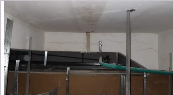
Foto 4. Falla por corrosión con fisura ubicada casi a la mitad del peralte de la viga, lo que implica un alto recubrimiento o la posible falta de flejes. Nótese que la fisura se transmite hasta la viga de apoyo
